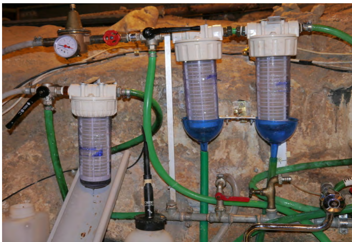
Impianto di filtrazione e distribuzione delle acque
