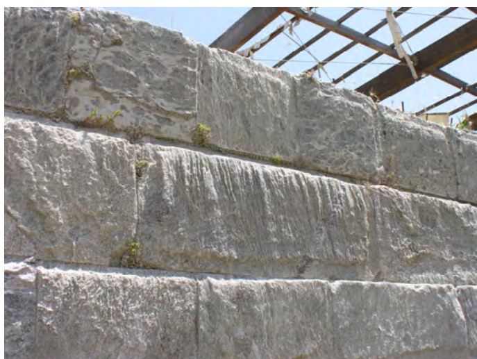
Fig. 5 – Piccole scannellature sub-verticali su blocchi di gesso portati alla luce da scavi archeologici.
